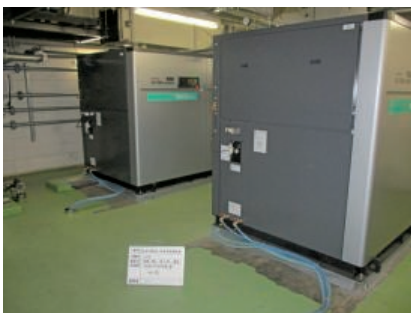
更新後コンプレッサー（新タイプで電力使用量30%削減）
