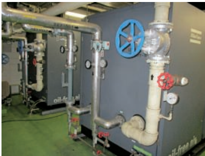
更新前コンプレッサー
